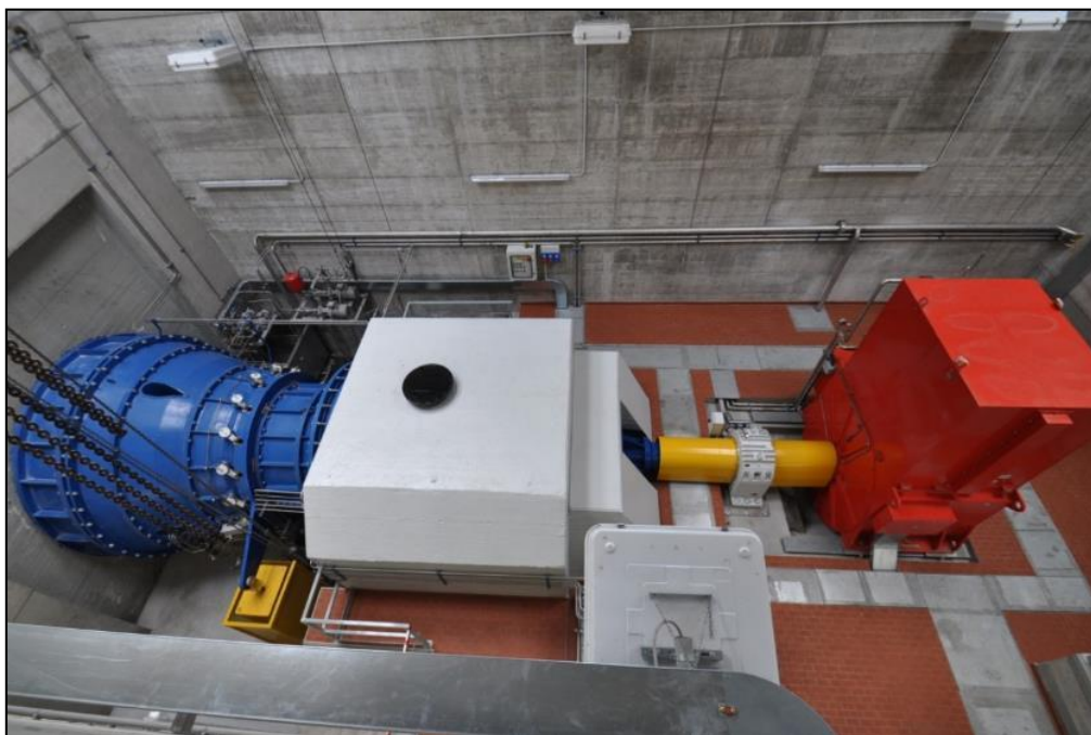
Fig. 2.14 – Centrale idroelettrica Montina in Comune di Ponti sul Mincio
