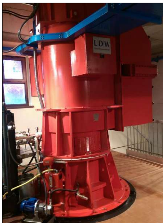
Fig. 2.15 – Centrale idroelettrica Esenta in Comune di Lonato del Garda
