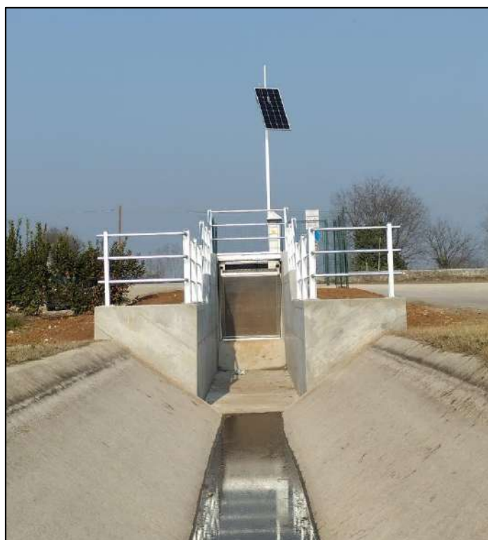
Fig. 2.38 – PNRR – Apparecchiature di telecontrollo e automazione rete irrigua
